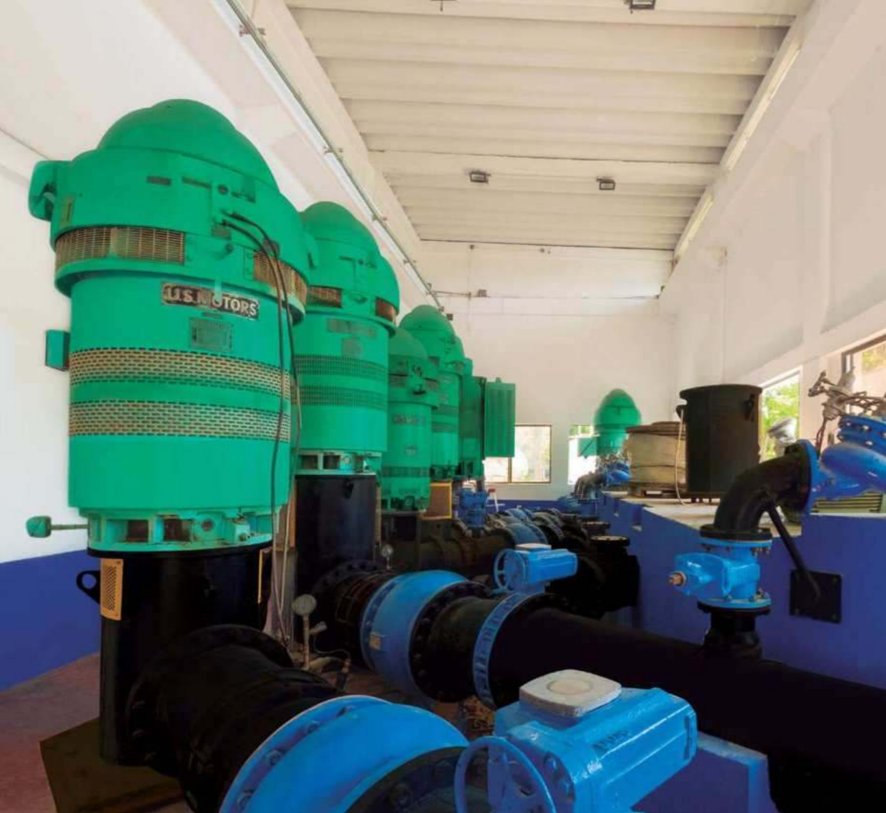
Estación de Bombeo de Agua Cruda Albornoz.
