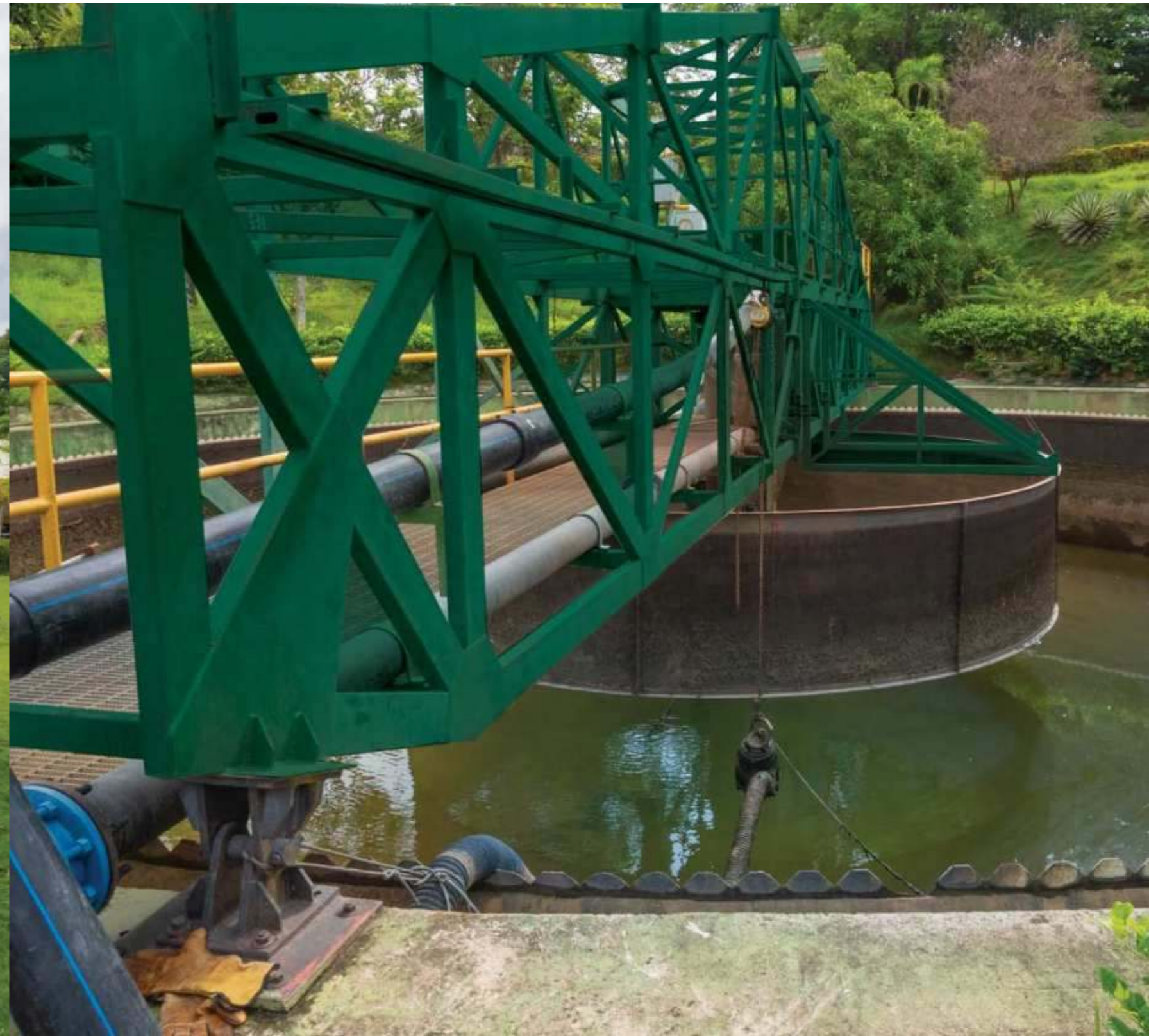
Planta de lodos.
